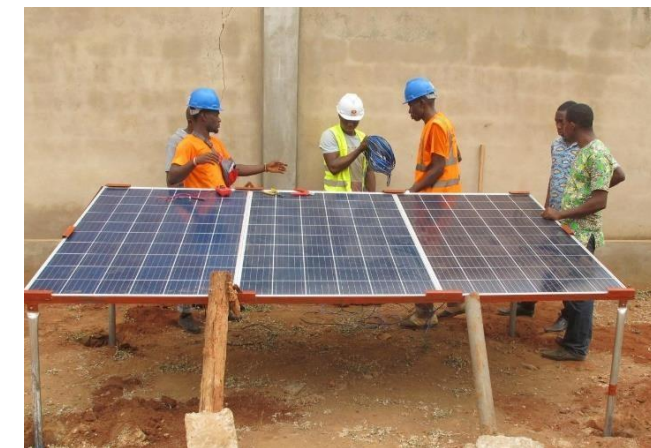
Photovoltaik neuer Schwerpunkt im Bereich Elektrotechnik
